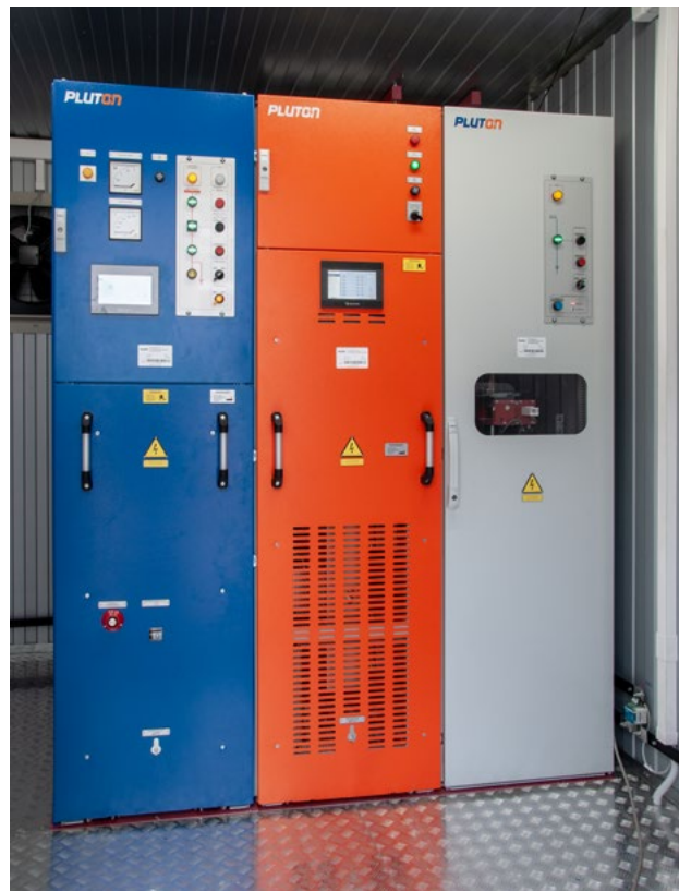
▲ Szafa kabli powrotnych (z prawej strony), Wysuwny prostownik (pośrodku) Rozdzielnica prądu stałego (z lewej strony)
