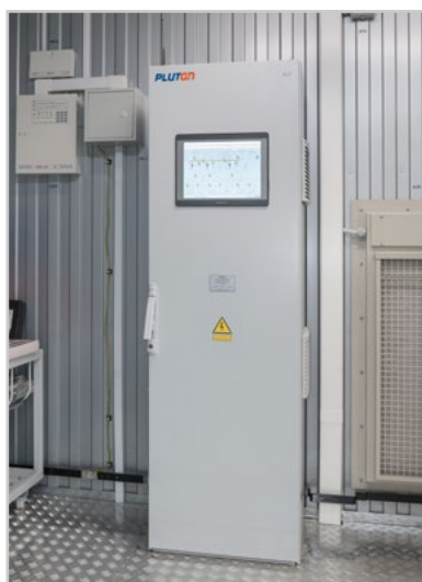
Szafa telemechaniki ShTM
