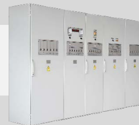
Urządzenia rozdzielcze niskiego napięcia:
