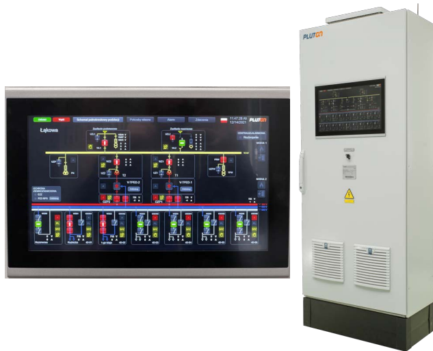
2 poziom. Sterowanie podstacji
