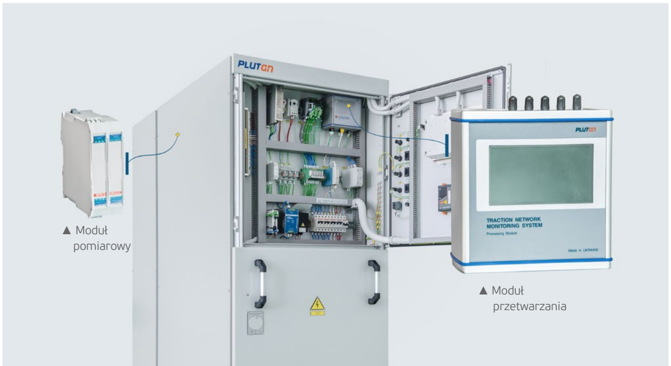
▲ Moduły systemu SMTN-3 w składzie rozdzielnic prądu stałego
